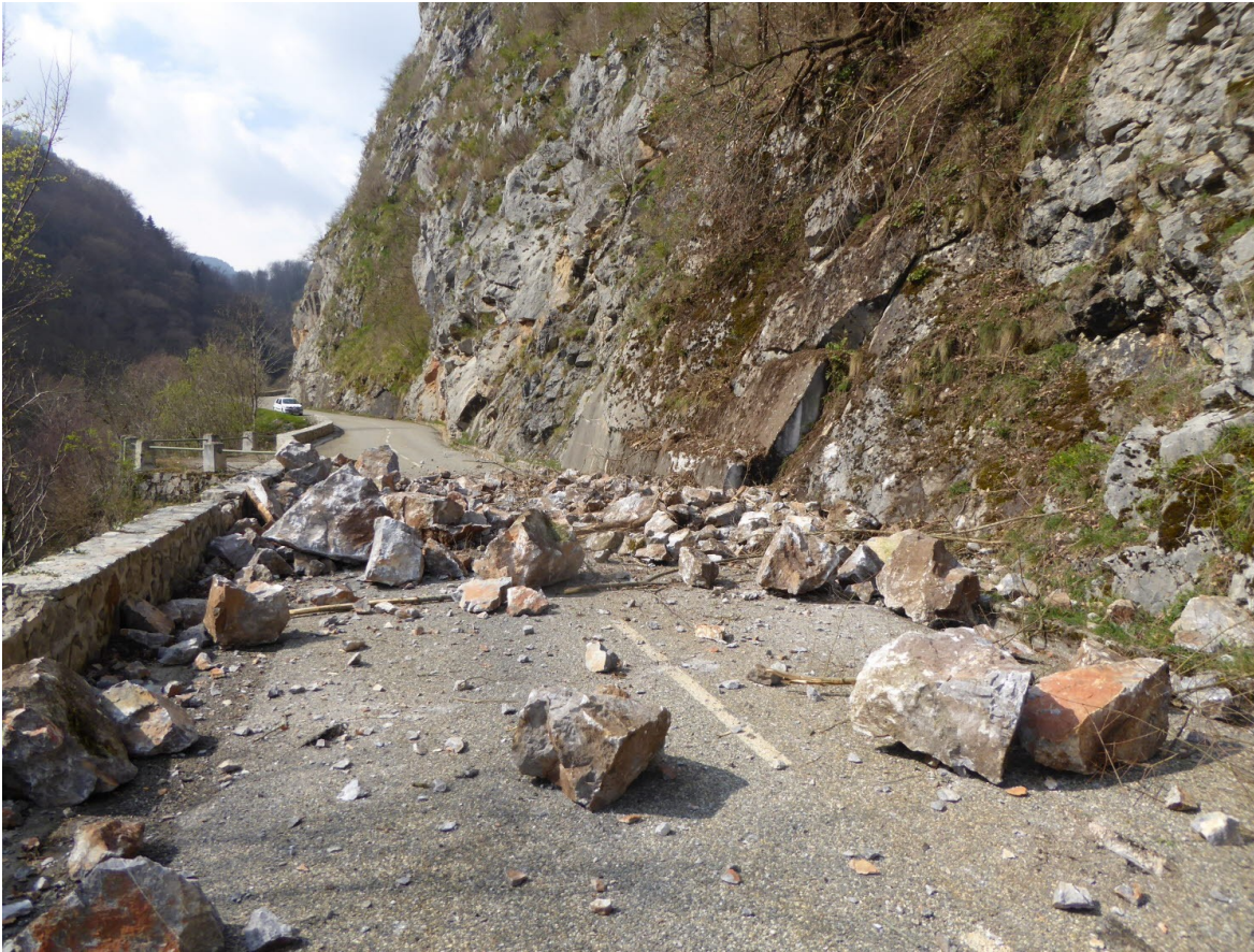
Éboulement sur un route en Ariège
